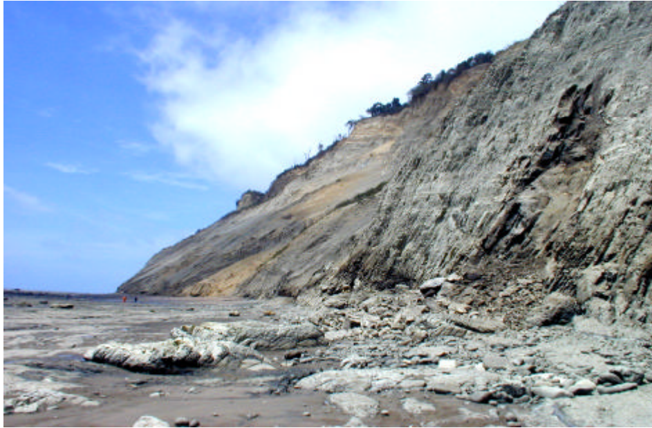
Foto 3. Al fondo de la foto se observa un deslizamiento de roca y lodo provocado por las fuertes lluvias durante el fenómeno El Niño 92/93, que aún no ha sido limpiado en su totalidad por la erosión marina. En primer plano se observa un derrumbe de roca ocurrido en el momento del levantamiento, debido a la erosión del pie de acantilado.
