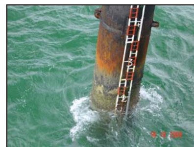
Matériel installé, premier enregistrement à 10 heures (19/10/2006)
