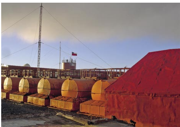
Figura 2. Estanques de combustible, Base O'Higgins.
