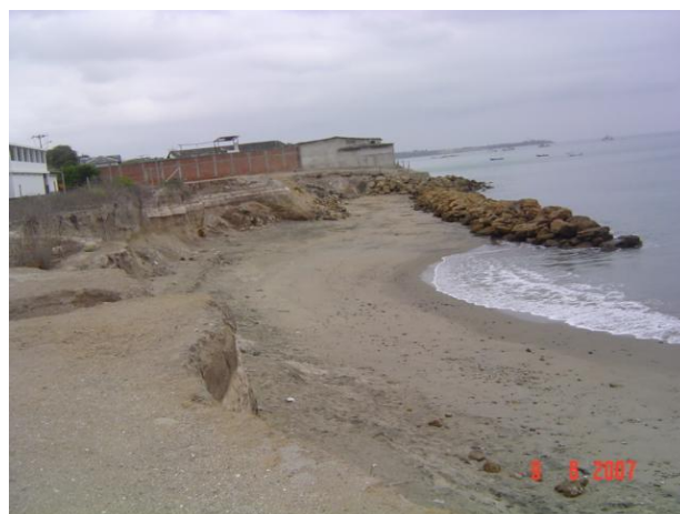
Foto 5.- Muro de contención construido para minimizar el efecto del oleaje en una vivienda, pero sin resultado positivo.
